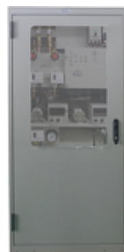
50LA2 (ガス分配架は 別設置)
