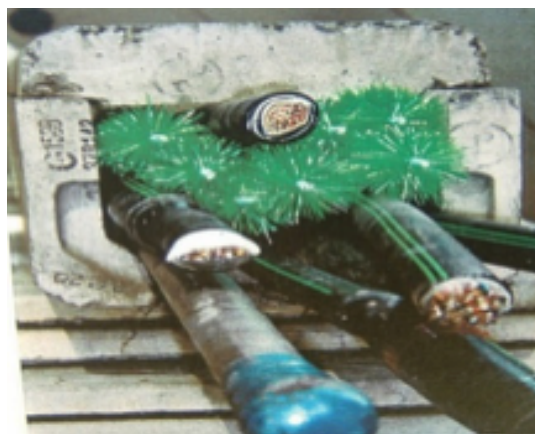
トラフ内での使用状況
